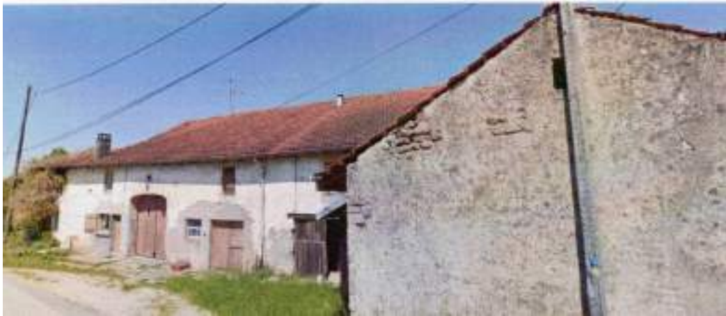
Photographie de la maison avec sinistres (2023).
