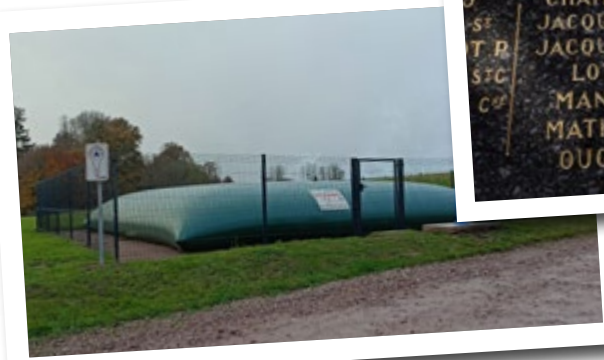
Citerne incendie de 120 m 3 à proximité de la ferme Alban Mathieu
